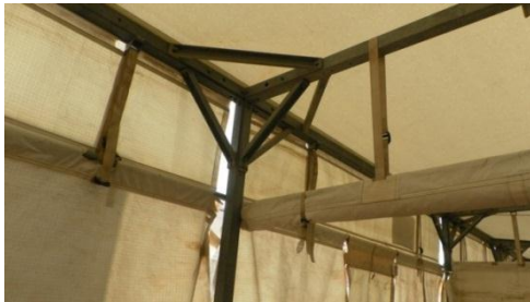
شكل رقم (4) الهيكل المعدني الداعم للإنشاء الخيمي بمشعر منى.
