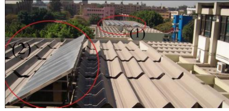
شكل (20) وضع الخلايا فوق السقف عند المسرح والصالة الرياضية وسهولة رويتها من المباني الخلفية مع عدم الوصول إليها، المصدر: زيارة ميدانية للباحثة.
