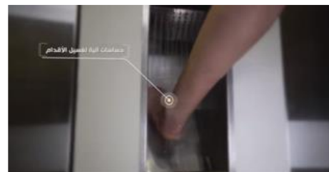
شكل رقم (٢٥): يوضح الحساسات الآلية لغسيل الأقدام بدورات المياه- تصوير الباحثة
