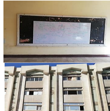
شكل (9) يوضح تهالك أدوات التعلم وسقوط أجزاء من الدهانات والبياض في الواجهه الجنوبيه. تصوير: الباحث
