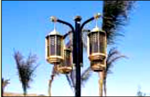
(الشكل 8): يوضح وحدات إضاءة. المصدر: تصوير الباحثين
