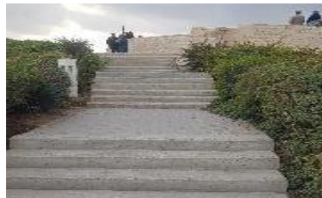
شكل (٣٠) السلالم الصاعدة للهضبة الجنوبية بدون حواف جانبية لتنبية الصاعدين من ضعاف وفاقدى النظر مما قد يتسبب في تعثرهم وسقوطهم. (تصوير الباحثين)
