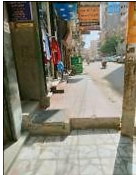
شكل 21 ارضية الرصيف وعدم الاستواء المصدر صور ميدانية للشارع
